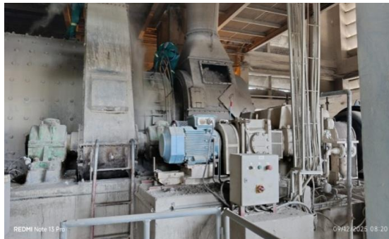
IMAGEM 25: Limpeza no motor do moinho (Cimentos de Moçambique).
